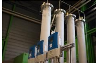
ODySEA-Versuchsanlage in den Räumlichkeiten von Cetim, Nantes (die Druckluftkammern)
