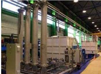
ODySEA-Versuchsanlage in den Räumlichkeiten von Cetim, Nantes (vollständige Installation)
